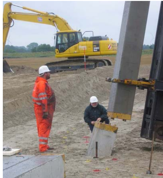
Abb. 1: Einer von 72 Pfählen für die Gründung der E-112 Fig. 1: One of the 72 piles for the foundation of the E-112
