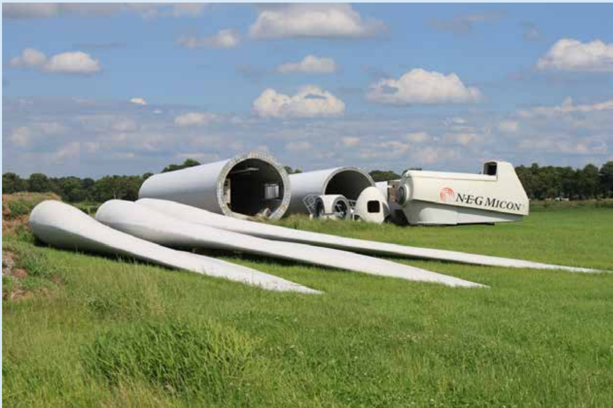
Fig. 4: Dismantled old wind turbine at Neuenhutorfer Moor wind farm (photo: Bernd Neddermann) Abb. 4: Abbau der Alt-WEA im Windpark Neuenhutorfer Moor (Foto: Bernd Neddermann)
